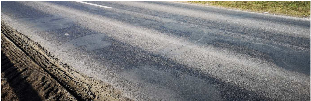
Figure 3 : Fissures importantes et accotements endommagés
